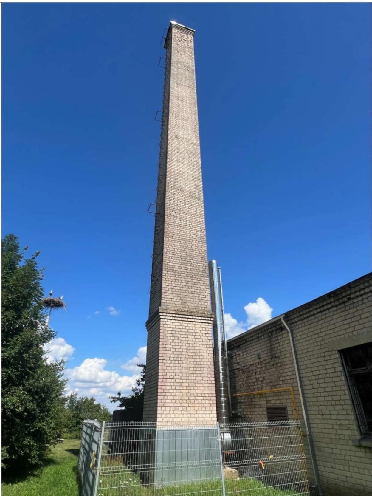
Viršutinėje kamino dalyje (~24-28,5 alt.) mūras stipriai pažesitas erozijos
