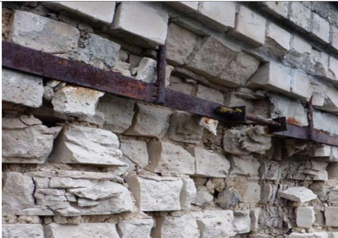
Suveržiamojo žiedo korozija, plytų mūro suirimas
