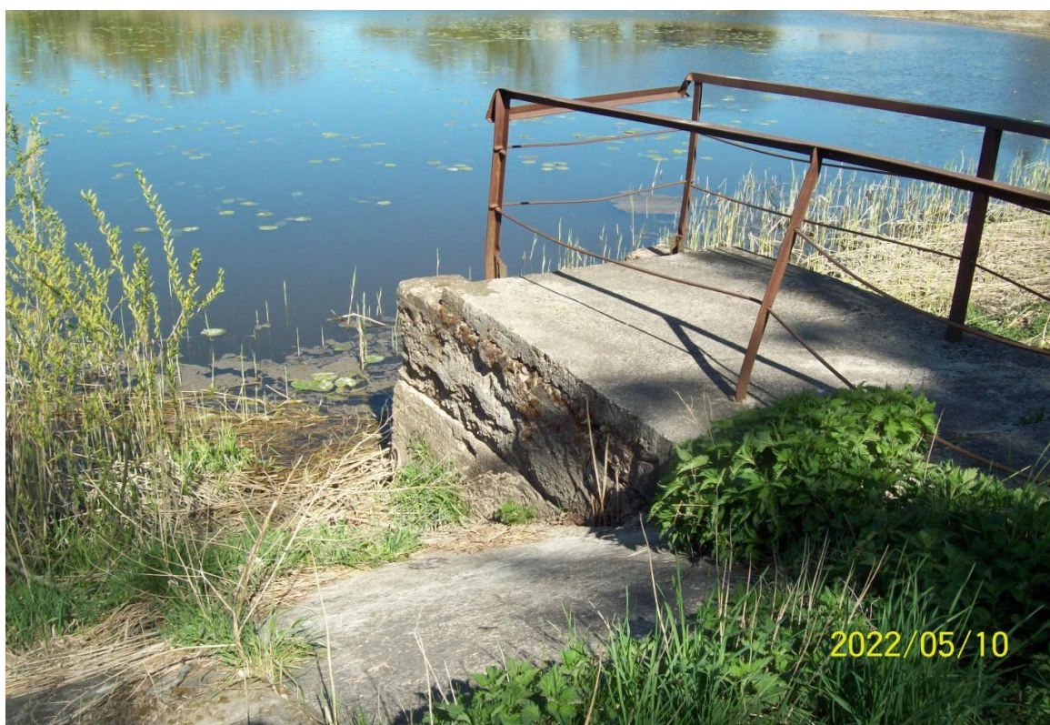
4.21 pav. Apiręs betonas PVP sienutės išorinėje dalyje.
