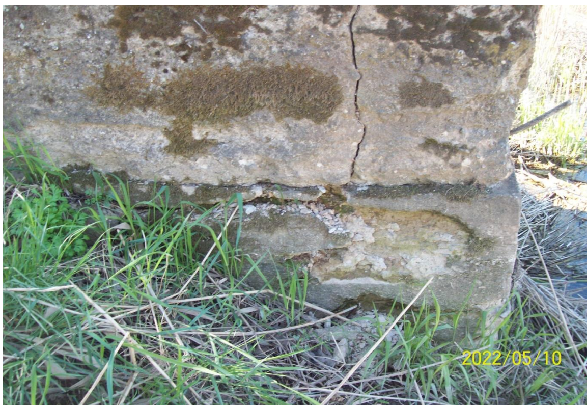
4.23 pav. Kairės pusės PVP sienutės deformacijos.
