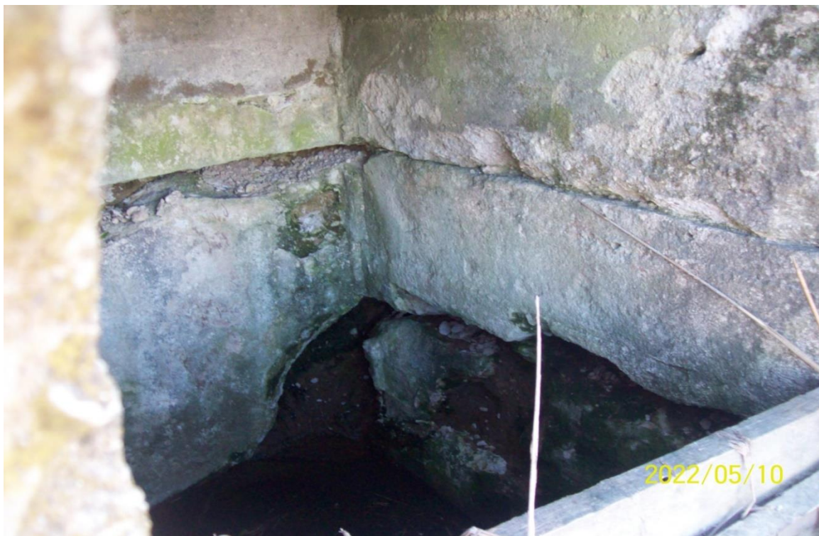
4.22 pav. Apiręs betonas šachtinės PVP sienučių vidinėje dalyje.
