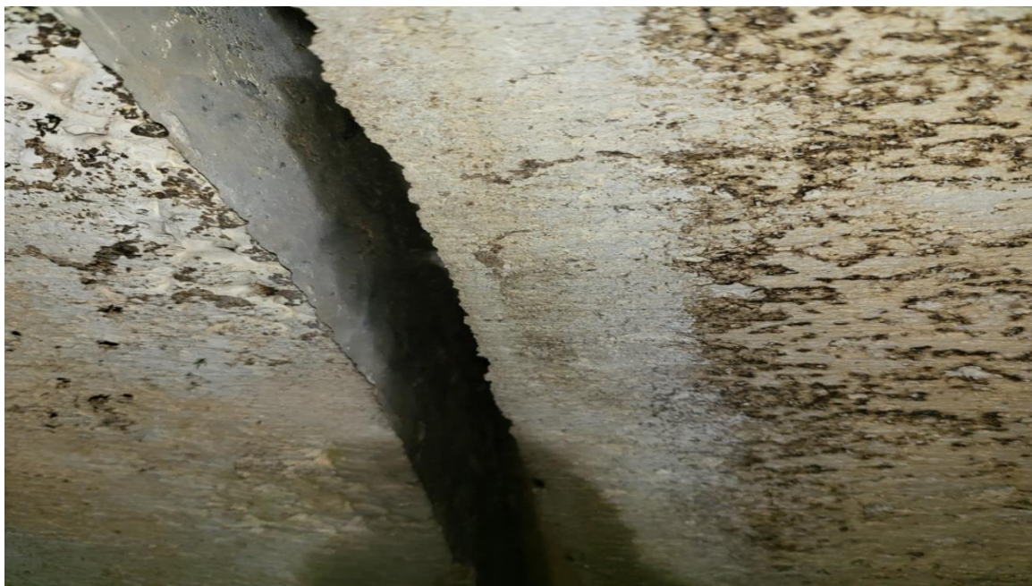
4.17 pav. PVP pratekėjimo dalies tarp vamzdžio ir atraminės sienutės susiformavęs plyšys.
