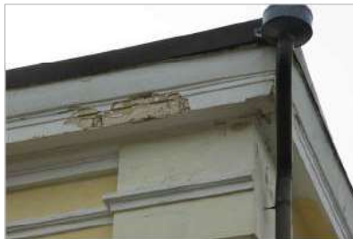
Esamas kamizas remontuojamame Igoninės komplekso pastate. Kamizo profilis sunaikintas, užtiknuoti ventiliaciniai plyšiai prie skardos.
