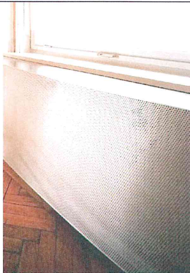
5 pav. Radiatorių uždengimo po palangėmis pavyzdys
